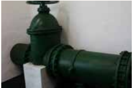
← Station de pompage Mails - St-Égrève
