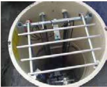
← Poste de relevage eaux usées - Grenoble
